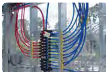
Sistema hidráulico tipo PEX
